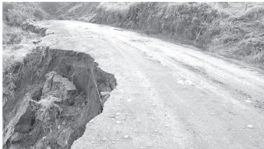
■ Vías afectadas en la parroquia de Isinliví.
