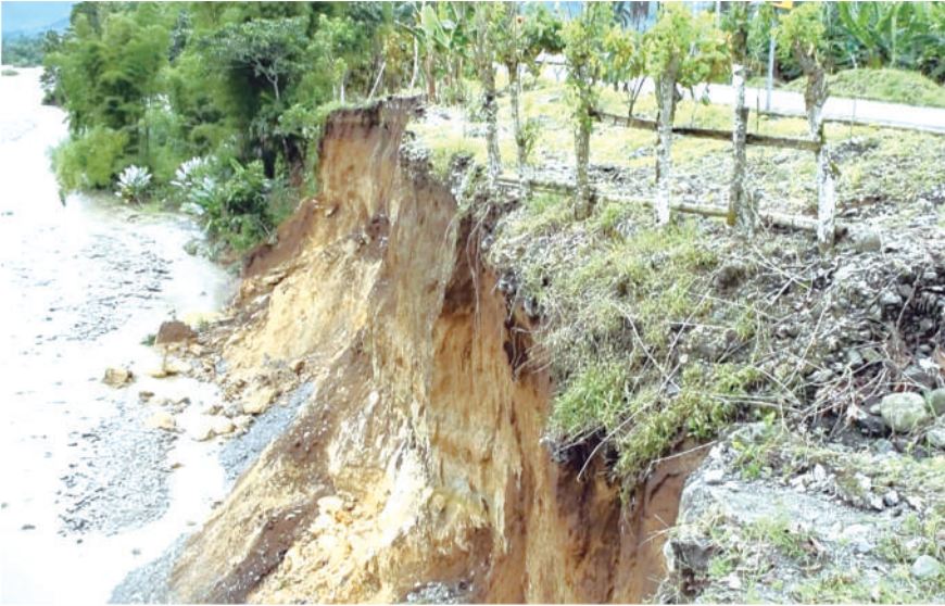
■ La carretera Latacunga-La Maná en el sector de la recta de Vélez en riesgo.
